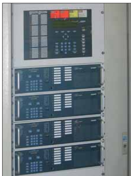
Beispiel für Schaltschrankeinbau
